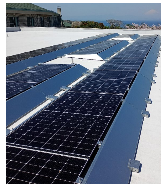
共通棟別館 設備容量10kw(2025年3月更新)
