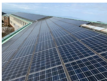
共通棟 設備容量 60kw
