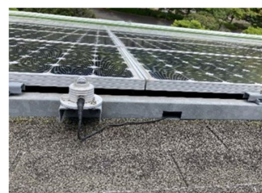
図書館棟 設備容量 20kw
