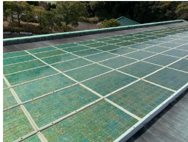
先導科学研究科棟 設備容量 30kw
