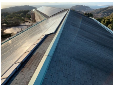
共通棟 設備容量 60kw ※2023年2月更新予定(40kw)
