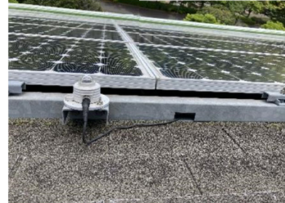
図書館棟 設備容量 20kw
