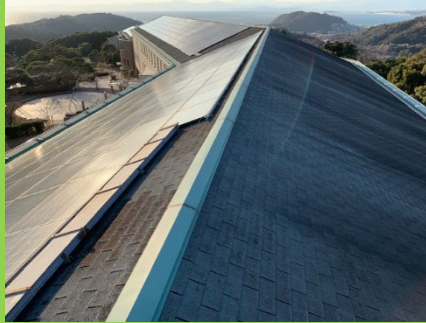
共通棟 設備容量 40kW
