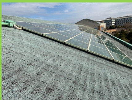
統合進化科学研究センター棟 設備容量 30kW
